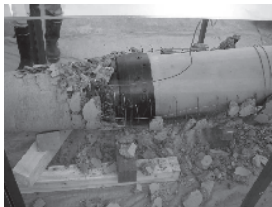
写真-1 φ250mmヒューム管破碎状況
